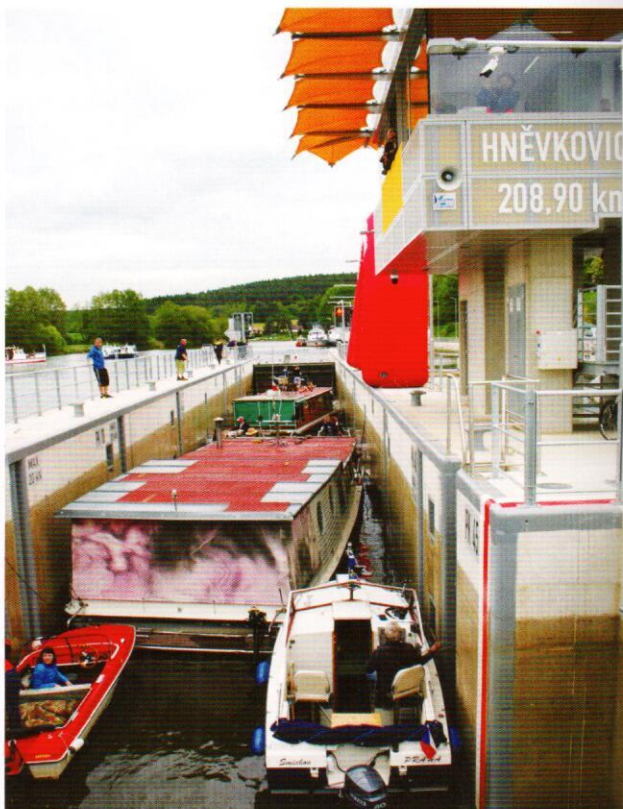
Plavební komora Hněvkovice praská ve švech
